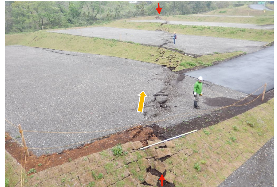
ふ た が わ 2016年熊本地震：布田川断層帯（熊本県西原村）右ずれ約70cm, 北側隆起20cm
